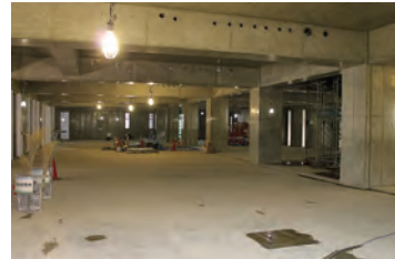
2階の内装。ラーニング・commonsを 整備し、キャリア支援室を 第2研究室棟から移転する予定。
