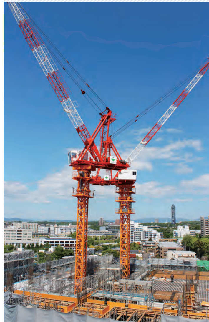
2機のタワークレーンにより効率的に工事が進められている。
